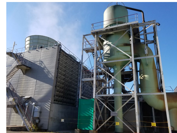
大沼地熱発電所
