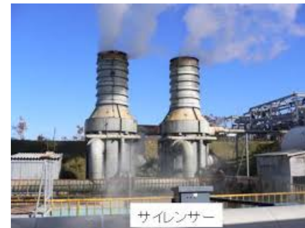
澄川地熱発電所
